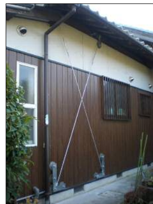
標準タイプ設置状況
